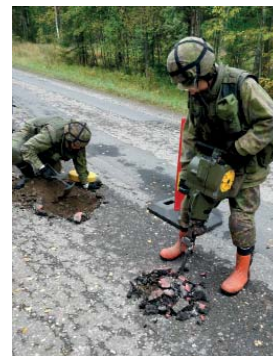
Suluttamista kestopäällystetiellä Juvalla.
